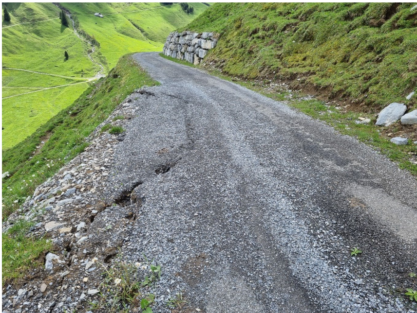
Rutschung von Strassen-/ Wegtrasseen
