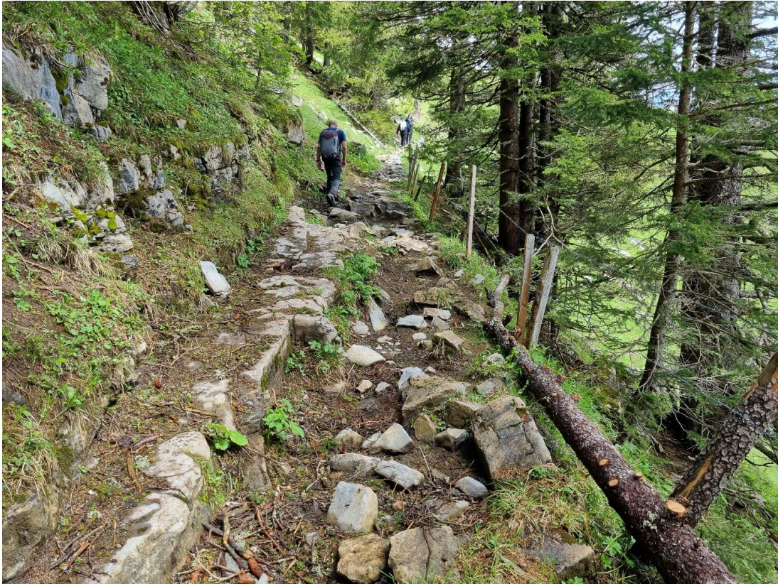
Erodierte IVS-Wegstrecke mit Unterhaltsbedarf
