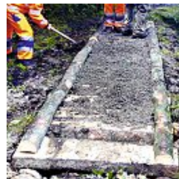
Fig. 18 Recouvrir le chemin de rondins avec de la terre et du gros gravier
