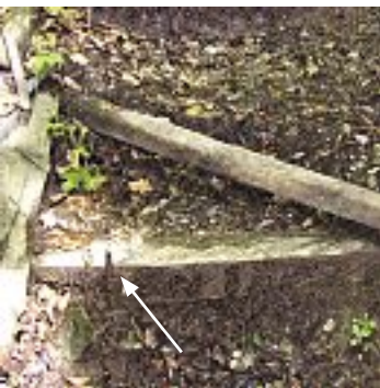
Fig. 86 Dépassement d'un fer d'armature
