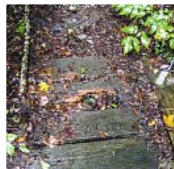
Fig. 93 Les feuilles mortes humides font pourrir les éléments en bois
