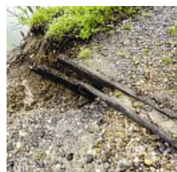
Fig. 95 Mauvais entretien de la rigole transversale
