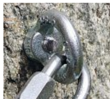
Fig. 65 Bon ancrage des chaînes
