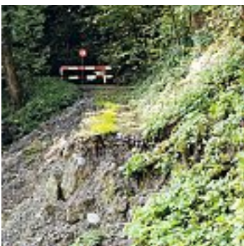
Fig. 92 Glissement de terrain
