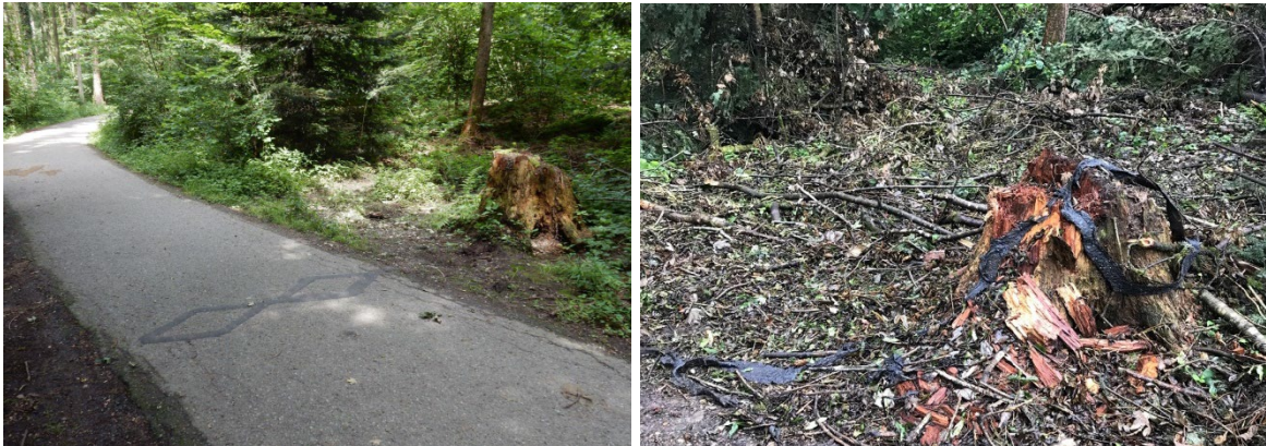
Abbildung 39: Die kombinierte Fuss- und Veloverkehrszählstelle vor und nach dem Sturm vom 13. Juli 2021 (Foto rechts: Marvin Bürgin)
