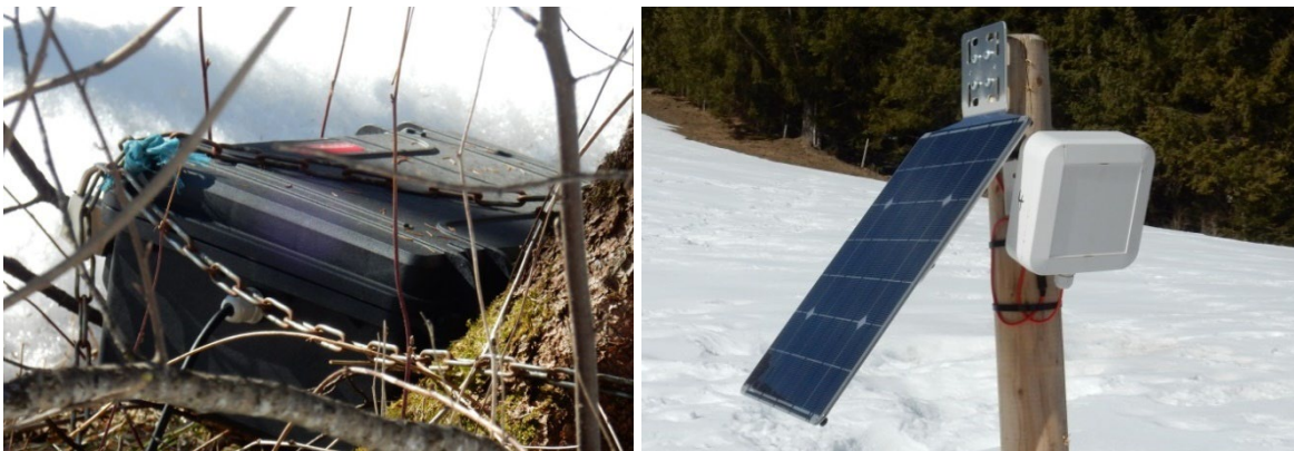
Abbildung 31: Stromversorgung mittels Akku (links) bzw. Solarstrom bei genügender Sonneneinstrahlung (rechts)
