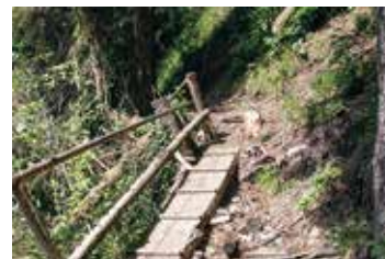
Le infrastrutture danneggiate che compromettono la sicurezza devono essere riparate.
