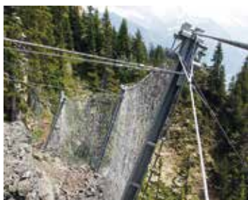
Reti paramassi sopra il sentiero di montagna Schynige Platte – Breitlauenen.
