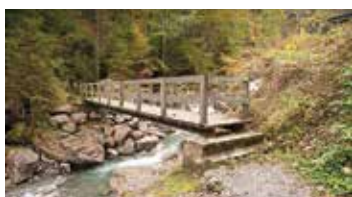
Sui sentieri gialli sono consigliati parapetti su entrambi i lati se il ponte attraversa un torrente con forti correnti.
